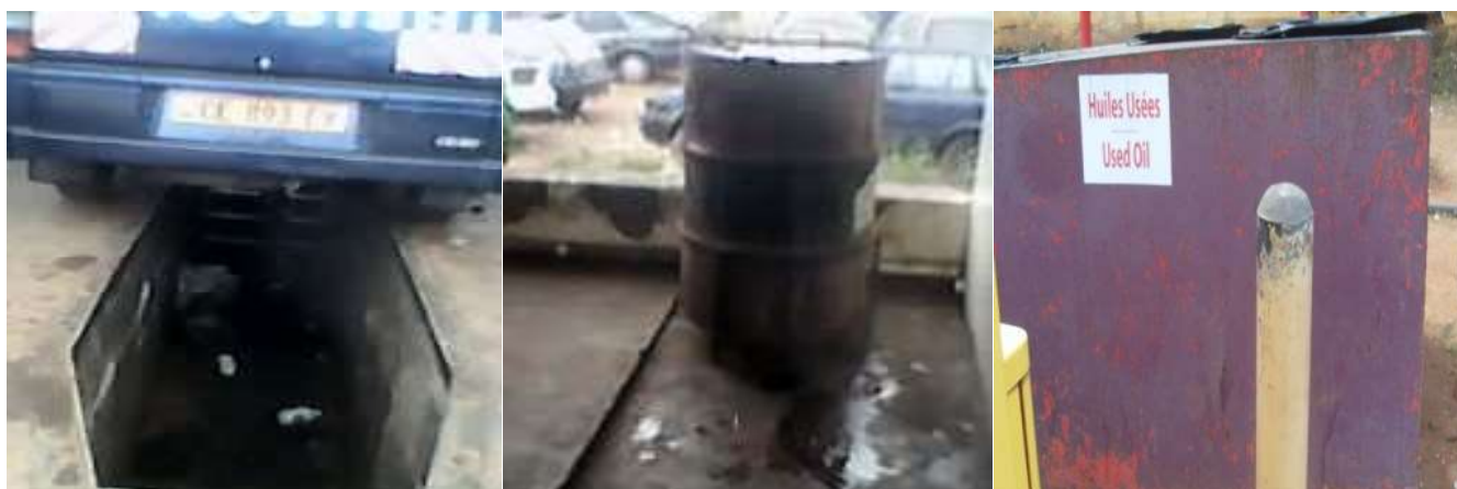
Photo 1.1: fosses étanches de stockage des huiles
